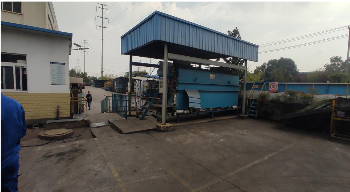
图 3-8 污水处理站及管道
